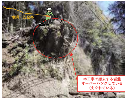
岩石崩落現場
